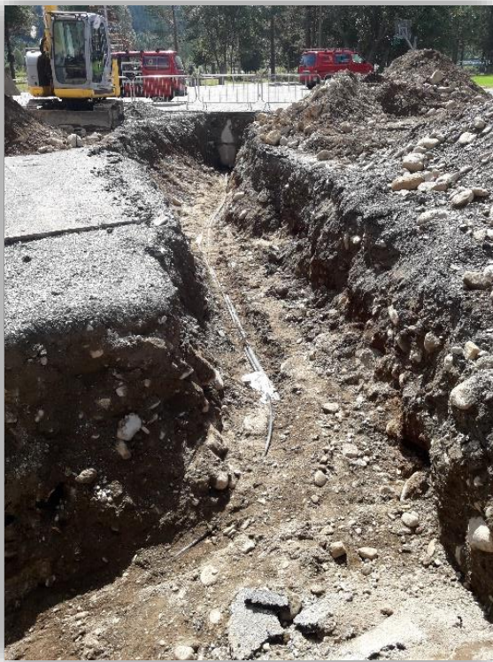
Figur 1 – Gravearbeid, vasslekkasje Høydalsmo skule
