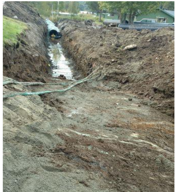
Omlagging av bekkeløp ved Høydalsmo alderspensjonat hausten 2017. Dette er ein del av prosjektet med opparbeiding av næringsområdet.
